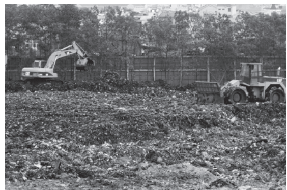
図4. ホーチミン市のGo Cat埋立処分場
